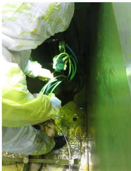
Maintenance TRP500 ligne ressuage.
